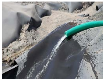
Agua de salida después del tratamiento en el separador. El agua está libre/limpia de partículas.
