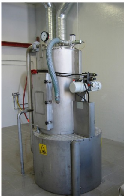
SAV 15-07, montado en el piso de una planta de tratamiento de aguas residuales municipales
