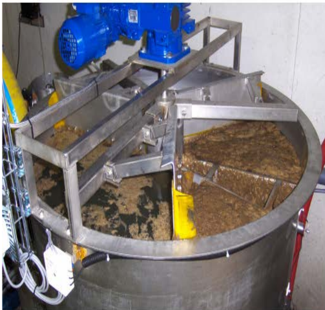
Separador FA 10 con el raspador y salida de lodos.
