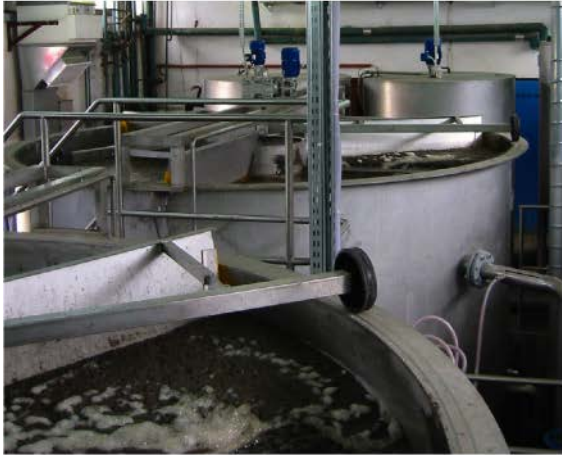
Tratamiento químico con flotación, dos separadores FA 80 Junto con dos etapas de preparación químicas y unidades de dispersión. Capacidad 225 m 3 /hora. Fotografía en un matadero.
