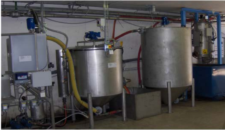
Plantas de tratamiento industriales, de izquierda a derecha: Unidad de preparación química, separador tipo FA 10, tanque de lodos, deshidratador SAV 10-05.
